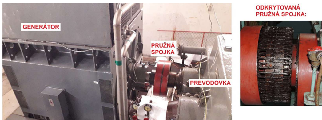
Obr.2 Časť sústrojenstva s vyššími vibráciami - vľavo (Generátor – Spojka – Prevodovka), odkrytovaná pružná spojka – vpravo
